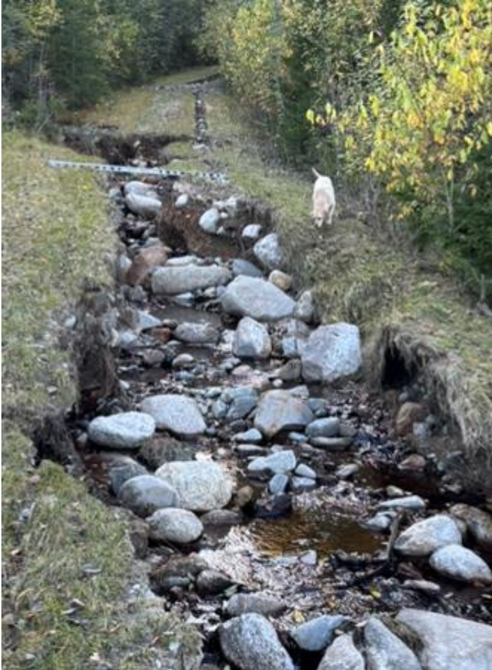
Figur 14. Vattnets erosion av skogsbilväg ovanför olycksplatsen.
