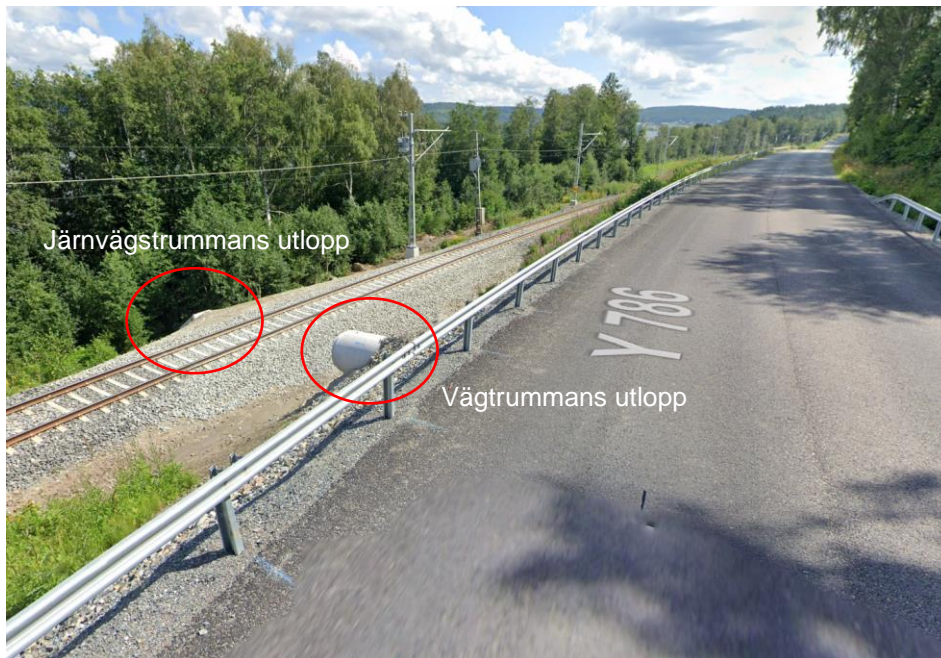
Figur 19. Trumma som leder vatten från avrinningsområde 1 under väg mot järnväg. Notera att ingen mottagande trumma under järnvägen syns, endast utloppet av trumman. Inloppet till järnvägstrumman är en kupolsil i diket längs järnvägen.
