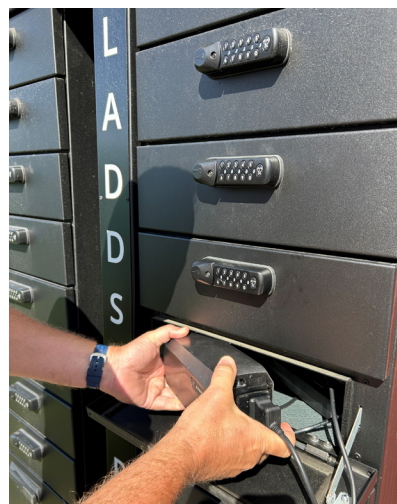
Exempel på laddskåp utomhus för elcykelbatterier. Här från VTI i Linköping.
