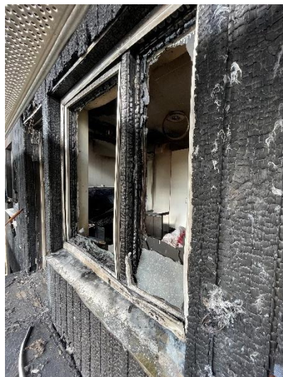
Figur 14. Brandskador balkong lgh 3a.
