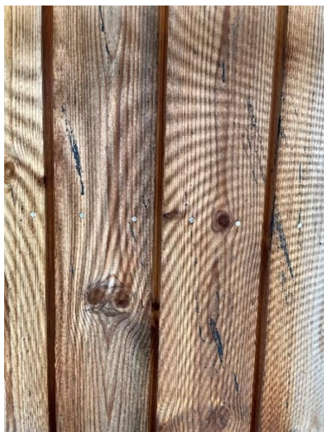
Figur 7. Stänk av plast på träpanelen.
