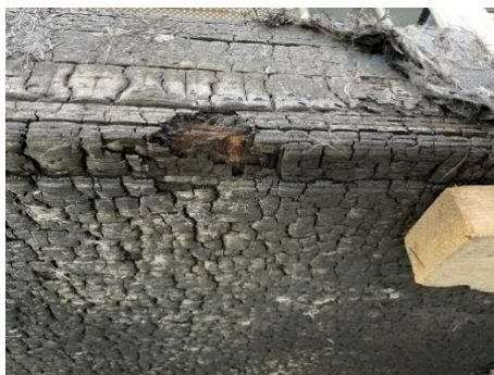
Figur 15. Brandskador undersida balkongplatta, lgh 3a.
