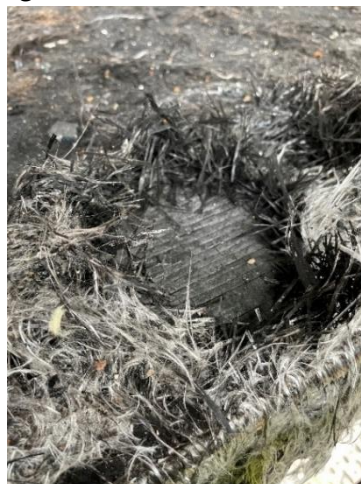
Figur 12. Brandskadad balkongplatta, lägenhet 2a. Ovensida.
