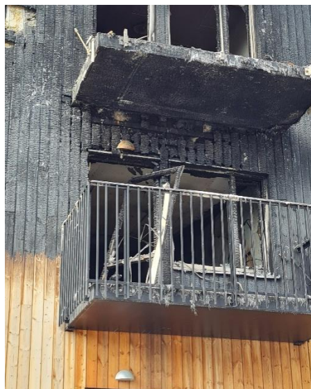
Figur 10. Brandpåverkad fasad, lgh 2a och 3a. Foto från Brandkåren Attunda.
