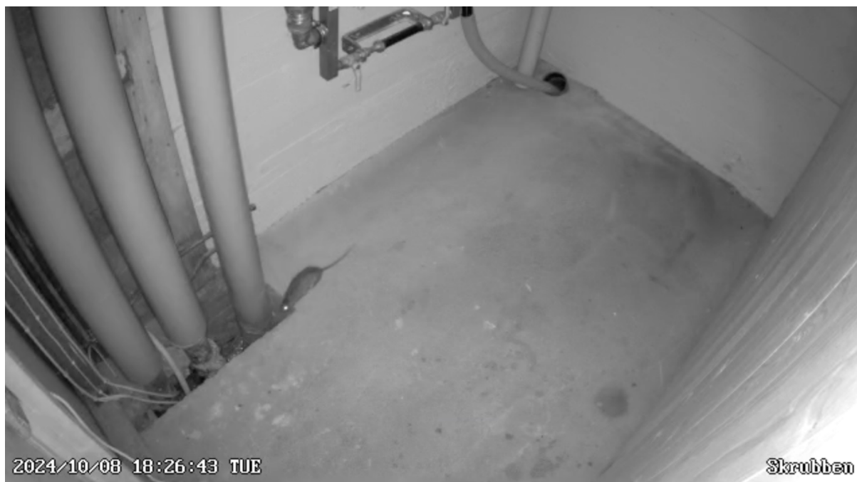
Figur 19 Råttan springer sedan över golvet mot installationsrören
